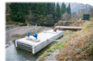
小水力発電施設
